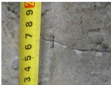
图 12-11 杭州某工程素桩裂缝开展 (胡琦等[3], 2008)
