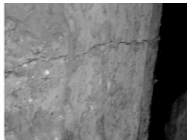
图 12-12 杭州某工程素桩裂缝开展 (廖少明等[2], 2008)
